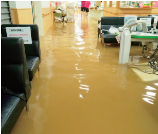
浸水した大牟田病院の外来フロア
